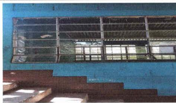
Foto 4: VIDRIOS Y VENTANALES EN DETERIORADOS
