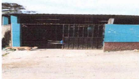
Foto 3: EL PORTAN YA ESTA EN MAL ESTADO TIENE QUEBRADOS SUS GANCHOS Y YA CUESTA DEMASIADO ABRIRLO
