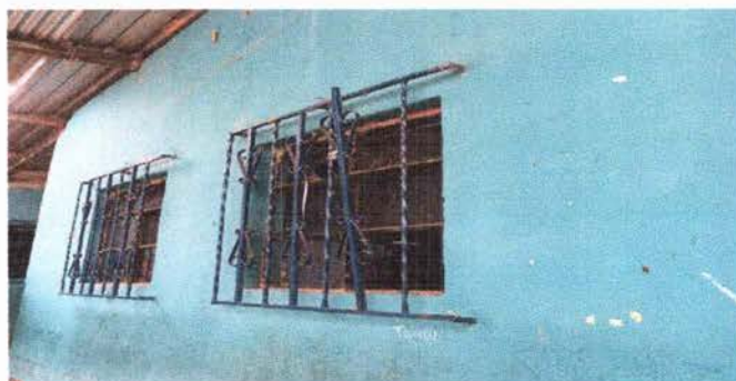
Foto 3: BALCONES EN MAL ESTADO
